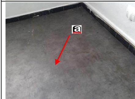
Photo n° PhA002 Localisation : WC; Salle de bains; Cuisine Ouvrage : 5 - Planchers et planchers techniques - Revêtements de sols Partie d'ouvrage : Dalle de sol Description : Dalle de sol
